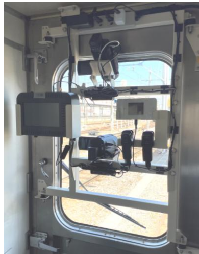
車両前面に設置されたカメラ
