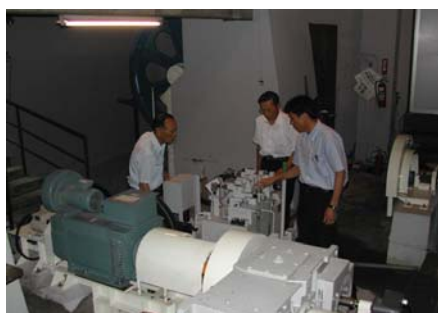
「設備の取扱い教育(油圧操作)」
